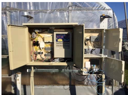
UECS環境制御機器YoshiMax(三基計装(株))
