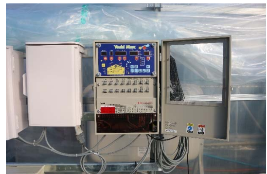
図 リニューアルしたYoshiMax。右の制御盤と左のボックス内のRaspberry Piが接続される構造となっている。
