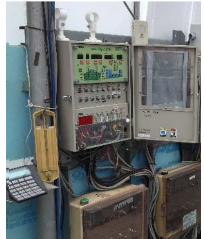
図 リニューアルした環境制御システム
